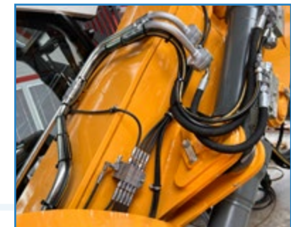
Schmierverteiler der Zantralschmierung
