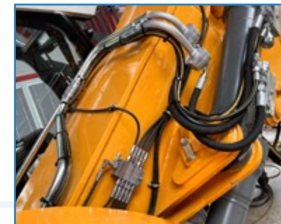
Schmierverteiler der Zentralschmierung
